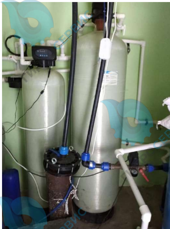
Рисунок 5. Водоподготовительное оборудование и оголовок скважины
