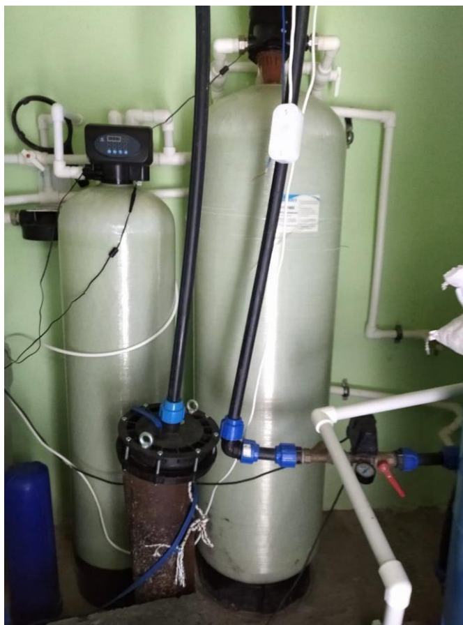
Рисунок 5. Водоподготовительное оборудование и оголовок скважины
